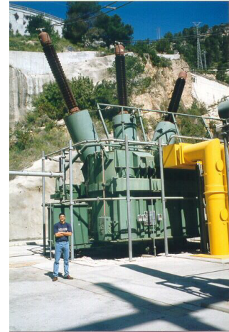
Figura 10-1. Transformador de la central de Cortes de Pallàs
